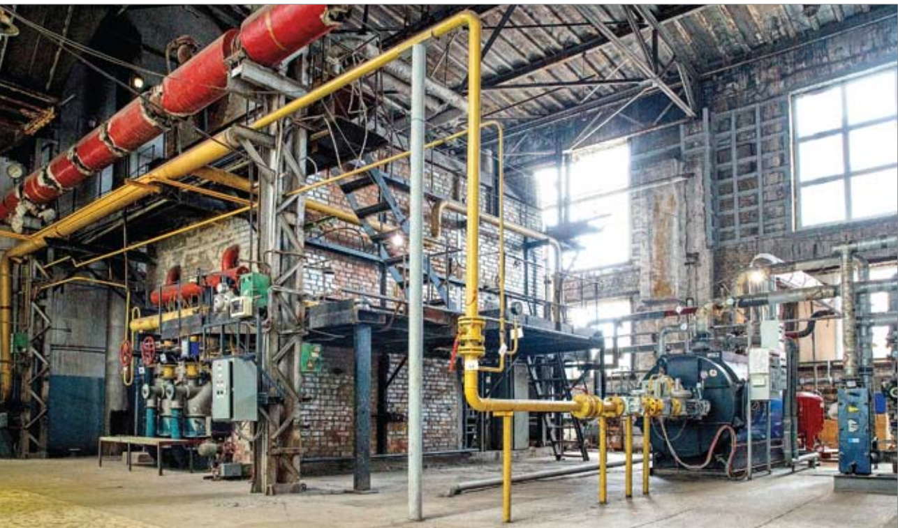
Котельная Центра культуры и бизнеса «Москва-Сокол».
